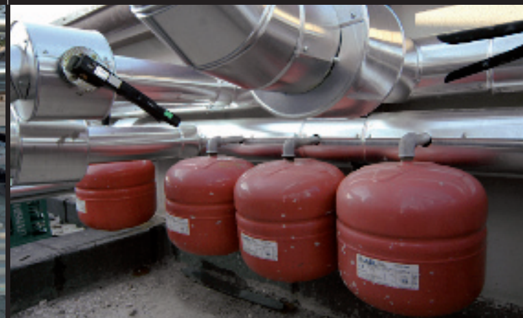
I VASI DI ESPANSIONE. I quattro vasi d'espansione presenti nell'impianto.
