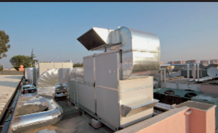
LE U.T.A. Una delle due unità di trattamento aria installate.
