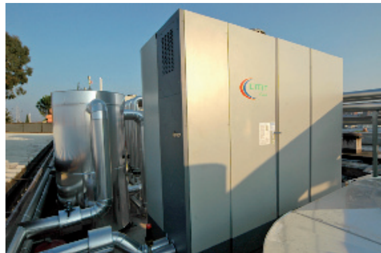
Uno dei due chiller a bromuro di litio forniti da CMT.
