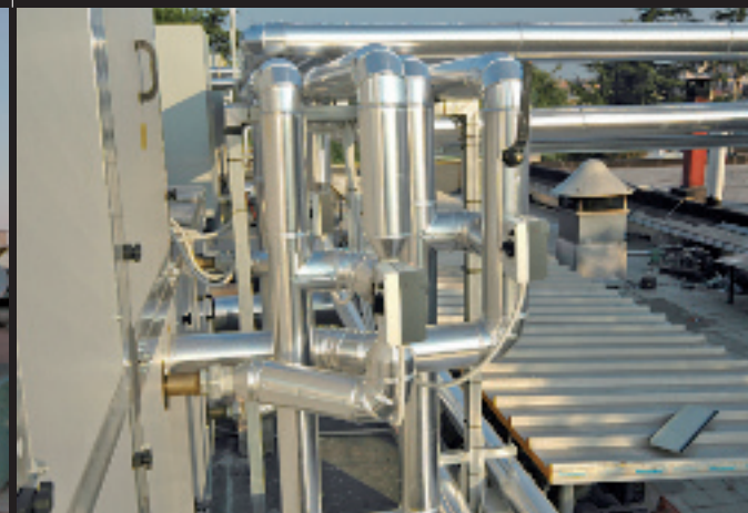
LA COINBENTAZIONE. Un dettaglio dell'impiantistica. Si noti la coibentazione rivestita d'alluminio.
