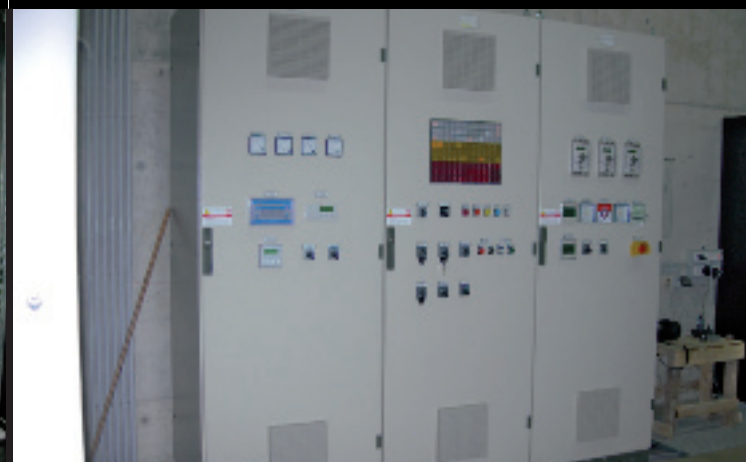
IL QUADRO ELETTRICO. Il quadro elettrico di parallelo e per la gestione ausiliari.
