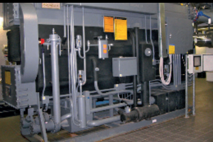
L'ASSORBITORE. L'assorbitore a bromuro di litio Broad installato presso il centro commerciale e distribuito da CMT di Parabiago (MI).
