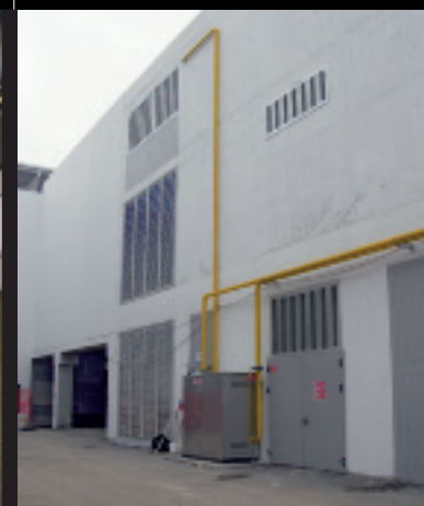
LA 'TRIGENERAZIONE'. La centrale di trigenerazione insonorizzata.
